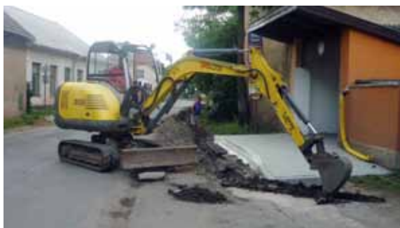
Využití uzavření ulice Boleslavská k rekonstrukci další části veřejného osvětlení bylo správným a logickým rozhodnutím.
