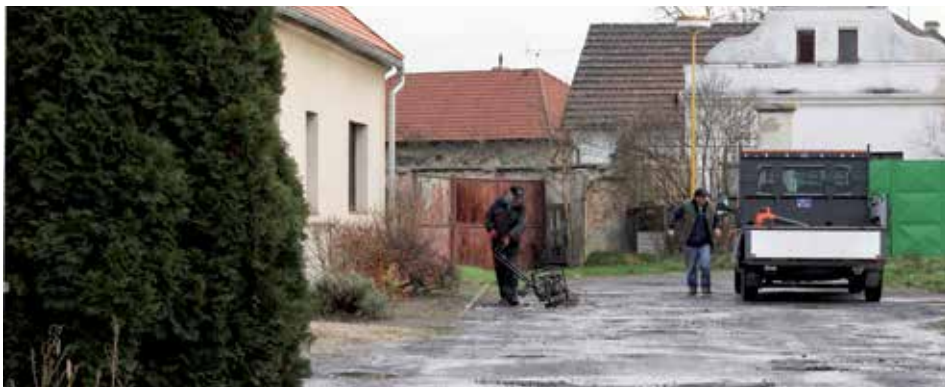
Ulic s nezpevněným povrchem je v naší obci několik kilometrů. Všechny se v dohledné době dočkají rekonstrukce.
