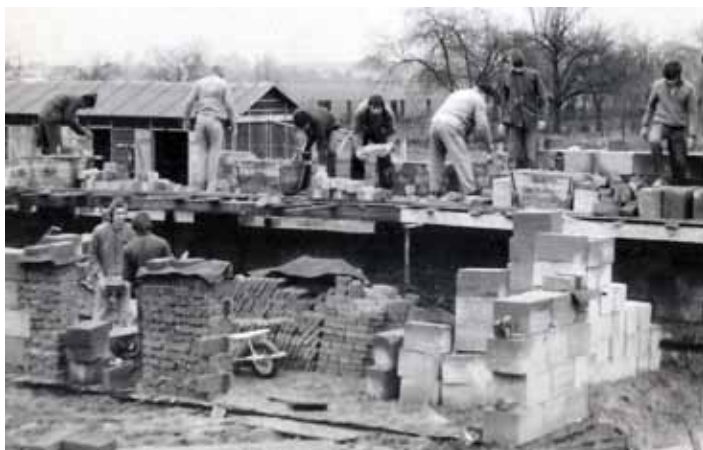
Na výstavbě školky se podíleli jak odborníci, tak i dobrovolníci z řad místních spolků.
